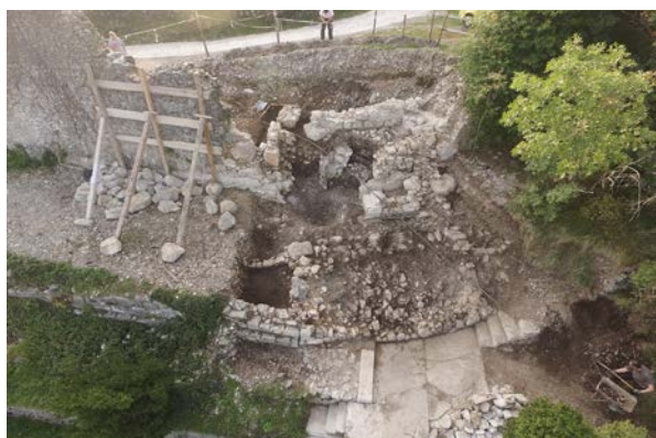
Pogled na stolp po odstranitvi betonskega tlaka. Pogled proti zahodu. Foto M. Pečovnik.
